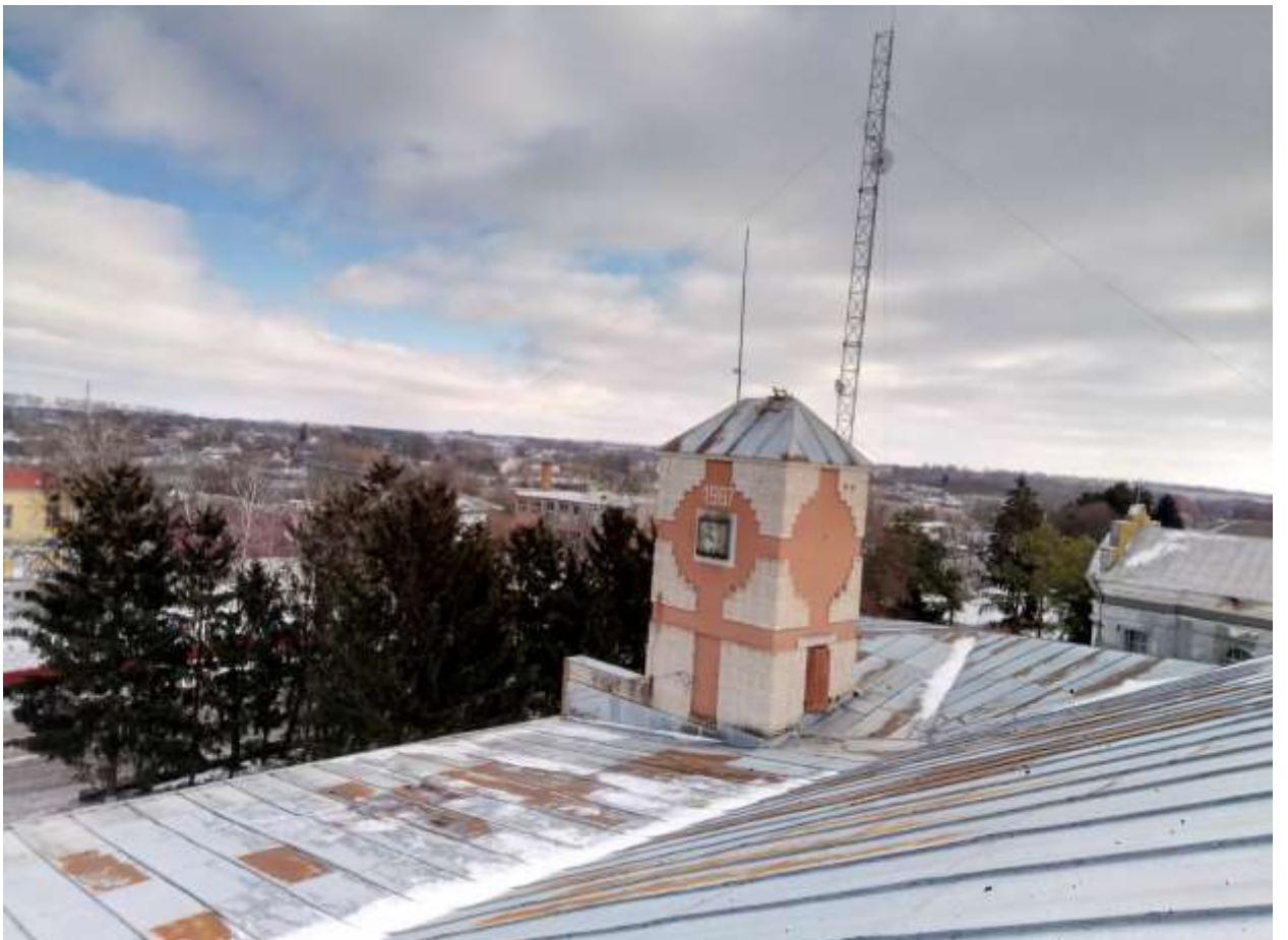
Фото 4. Загальний вигляд покрівлі. Корозія покриття
