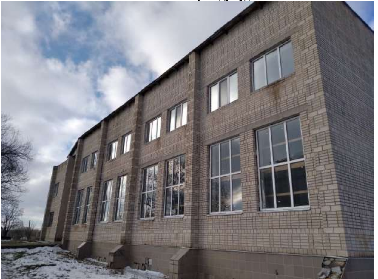
Фото 2. Загальний фасаду будівлі. Ділянки руйнування зовнішнього оздоблення. Ділянки замокання зовнішньої стіни будівлі
