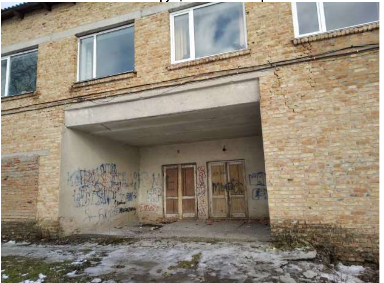
Фото 6. Загальний вигляд входу в будівлю. Тріщини зовнішньої цегляної стіни шириною розкриття до 2мм. Замокання зовнішніх стін.
