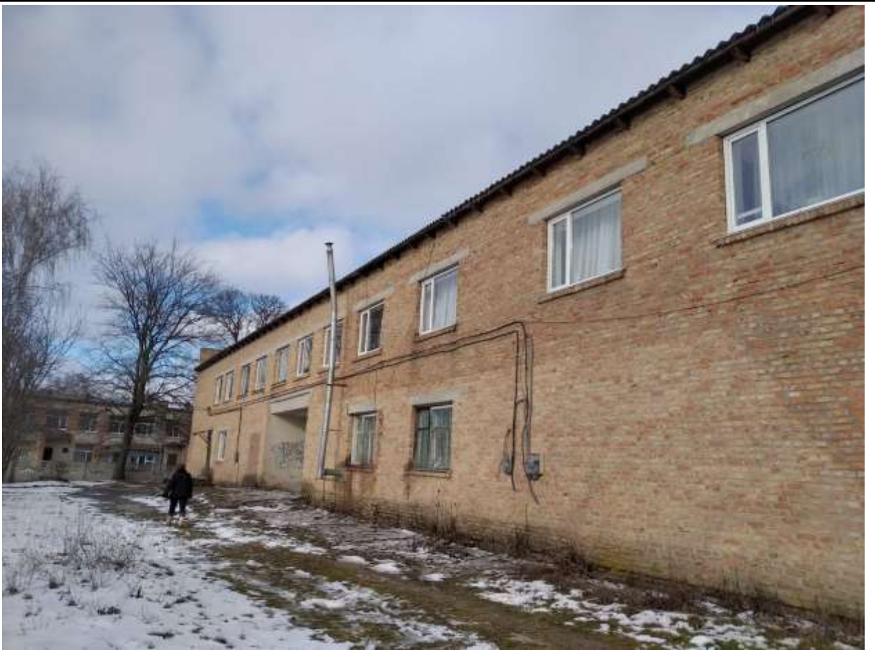
Фото 3. Загальний фасад будівлі. Ділянки замокання стін будівлі.
